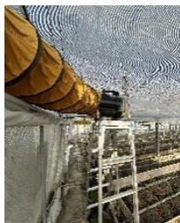
外気導入 ダクトファン
